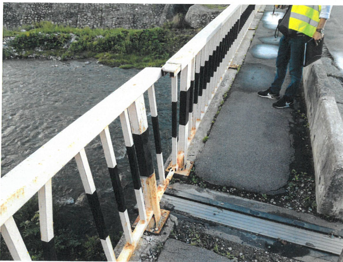
Foto nr. 13 – Parapet cu geometrie generală necorespunzătoare în plan vertical și/sau orizontal, sistem de protecție degradat (mățuit, pete de rugină, exfolieri, etc.)
