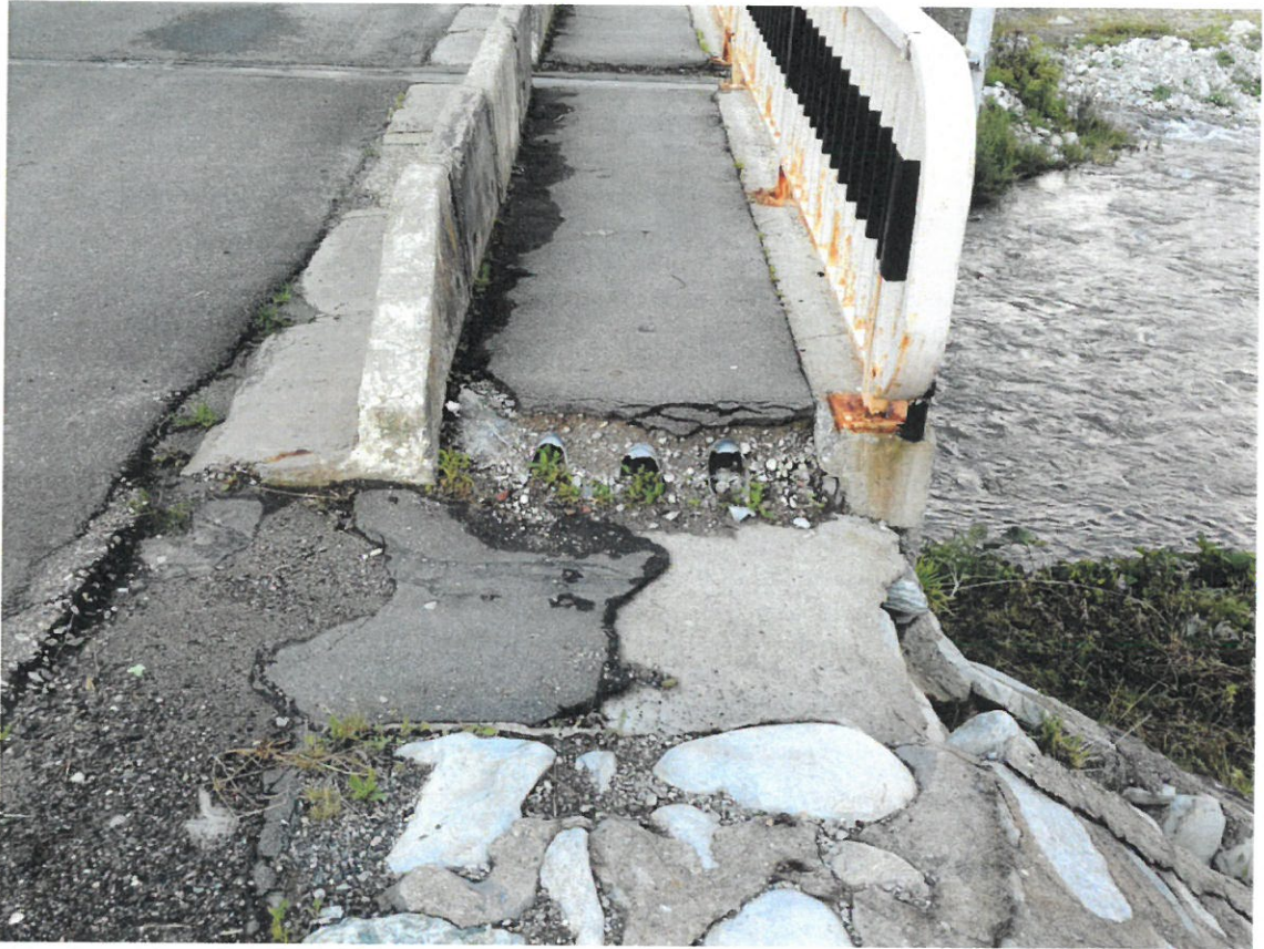
Foto nr. 17 – Alinierea în plan rampa-pod necorespunzătoare, lățime insuficientă a rambleului, acces dificil pe trotuarul podului, poziția incorectă a sferturilor de con
