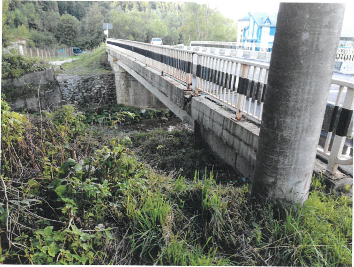
Foto nr. 15 – Lipsa sau degradarea parapetului de siguranță și/sau a unor elemente din parapetul podului
