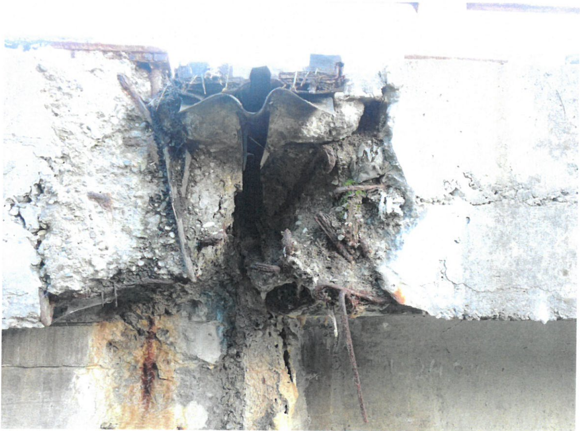
Foto nr. 16 – Degradarea dispozitivului de acoperire a rostului, a dispozitivelor de colectare și evacuare a apei, a elementelor de etanșare, infiltrații în zona rostului
