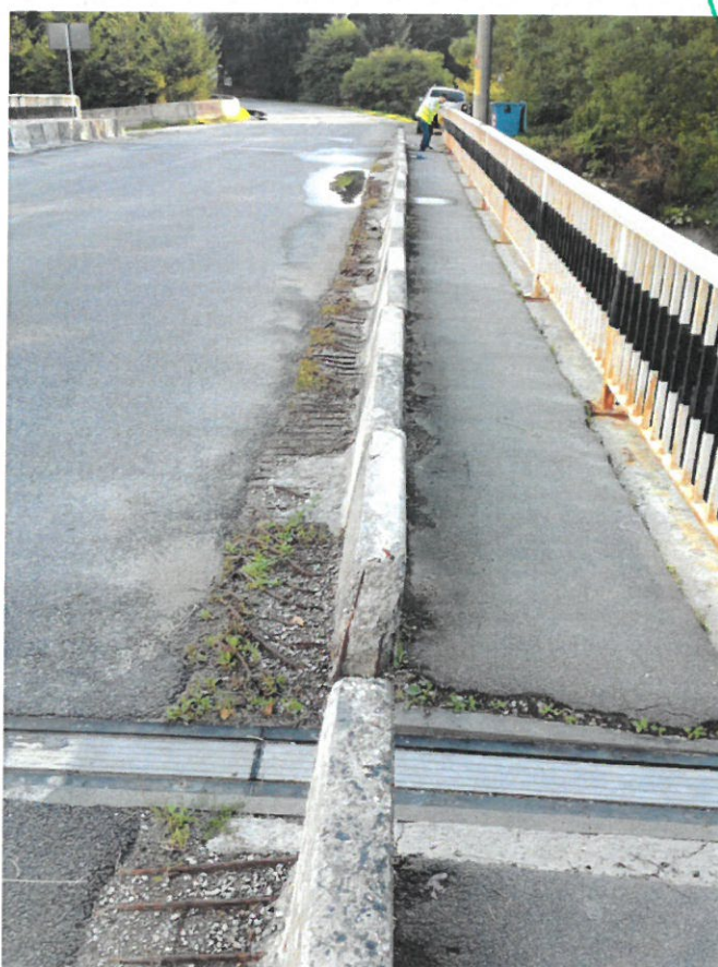
Foto nr. 12 – Denivelări ale căii pe pod, care favorizează sporirea efectului dinamic: vâluriri, refulări, fâgașe, praguri, gropi
