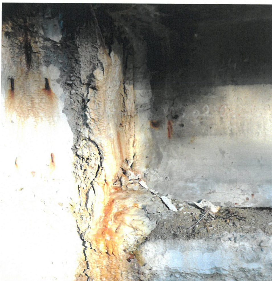
Foto nr. 6 – Blocarea aparatelor de reazem (blocarea deplasării suprastructurii datorită depunerilor și degradării beronului din zidul de gardă)
