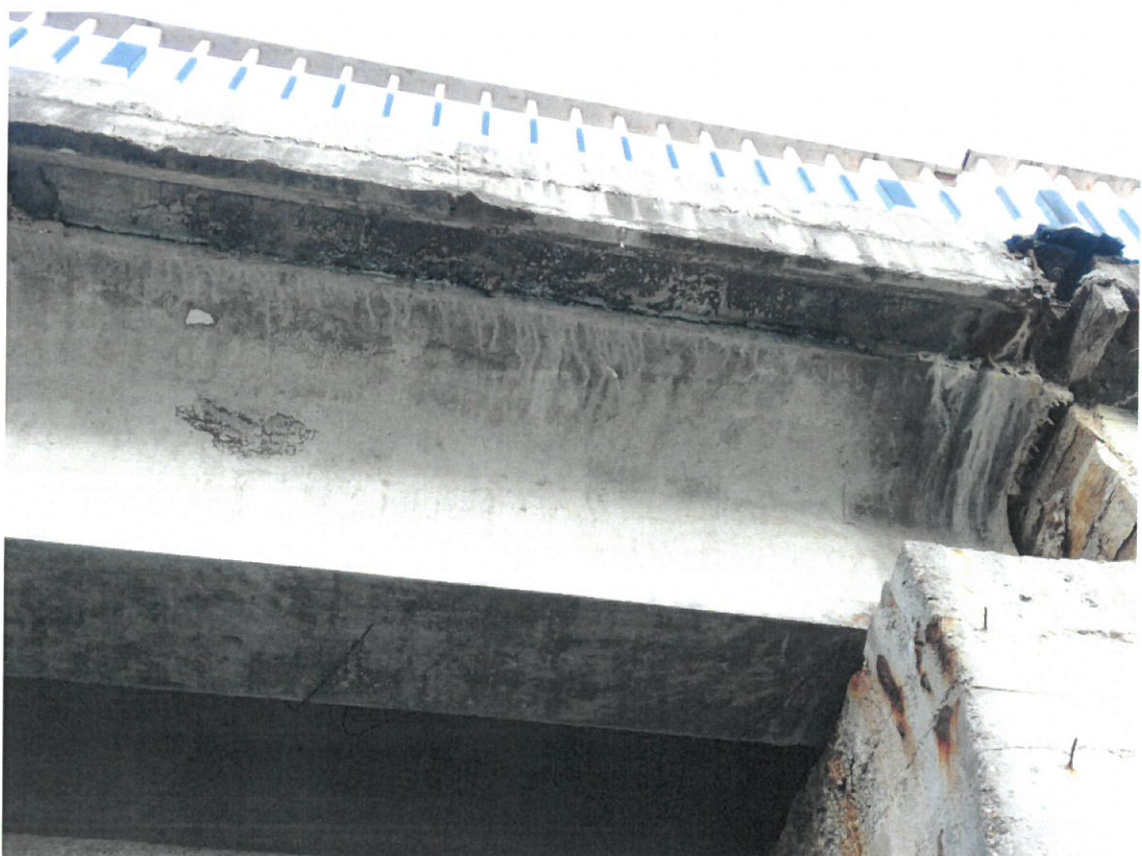
Foto nr. 4 – Infiltrații, eflorescențe la nivelul grinzii parapetului și la intradosul plăcii
