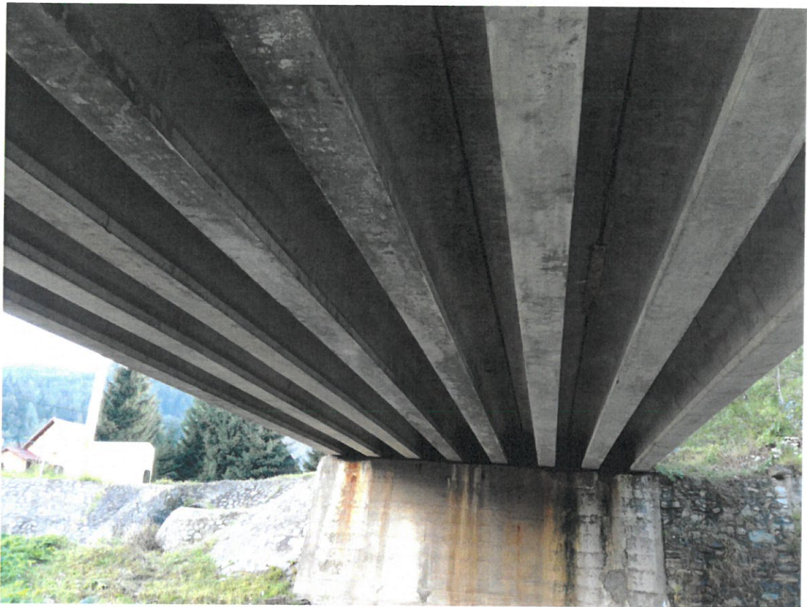
Foto nr. 3 – Defecte de suprafață ale feței văzute (culoare neuniformă, pete negre, impurități, pete de rugină, aspect prăfuit, imperfecțiuni geometrice, aspect macroporos, agregate la suprafață).
