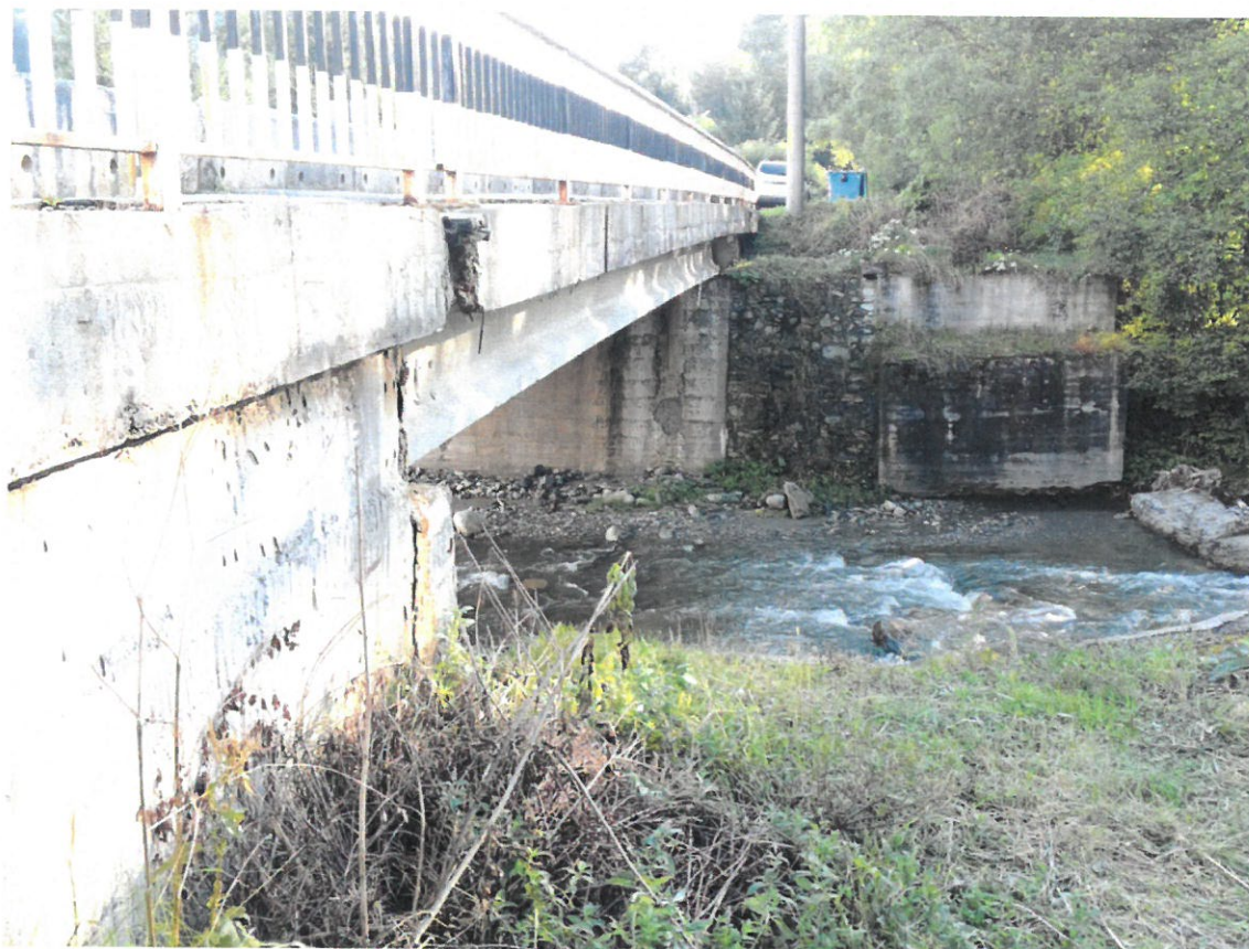
Foto nr. 19 – Modificări ale regimului hidraulic, coborârea etiajului în zona podului, adâncirea talvegului și afuierea zidului de sprijin din beton
