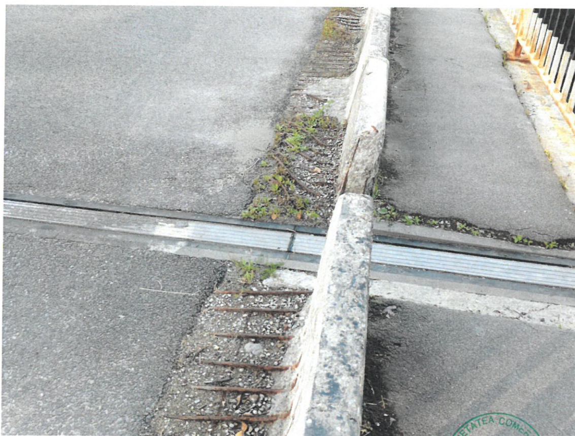
Foto nr. 11 – Degradarea sau dislocarea bordurilor
